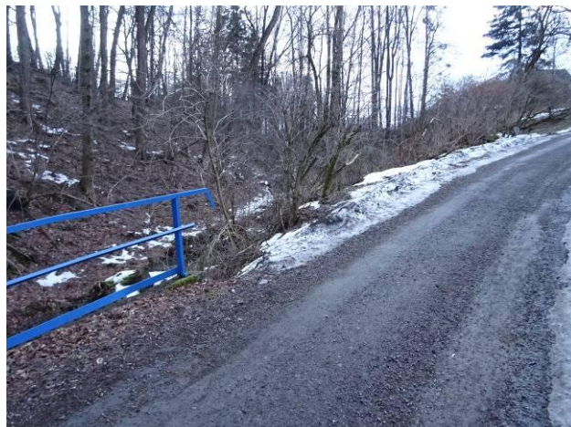
Levá krajnice za propustkem.
