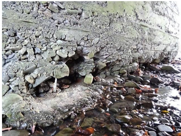
Eroze betonu OP1.
