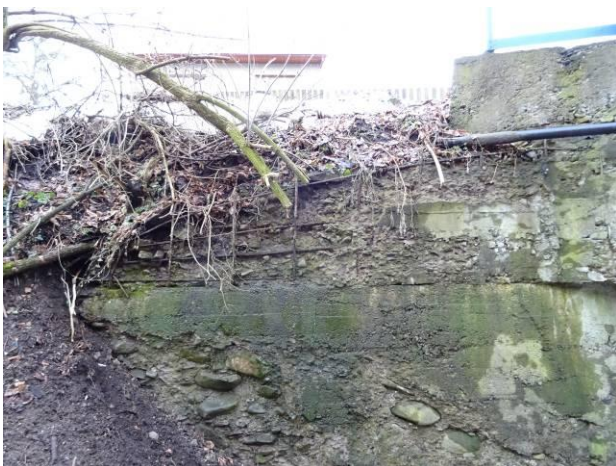
Křídlo K2L – rozpad betonu v horní části křídla.
